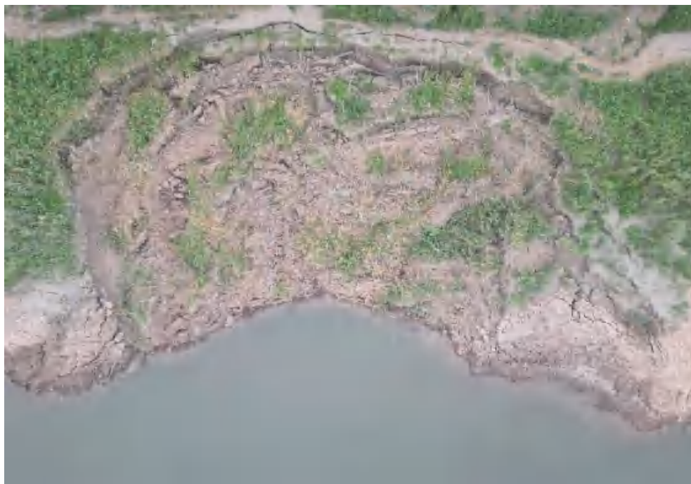
图 27 七弓岭河段七姓洲（16+610 ~ 16+730）崩岸
