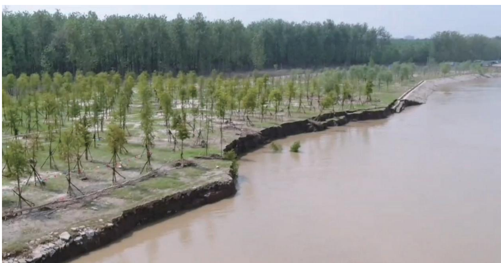
石首市荆南长江干堤北门口桩号 S9+280 ~ S9+410 堤段崩岸
