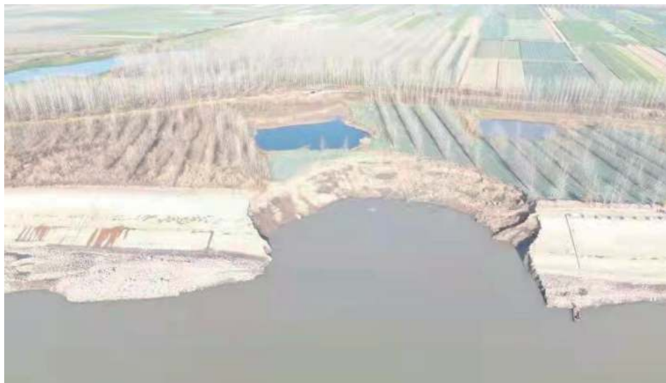
咸宁市长江簪洲湾河段肖潘赤壁段谷洲民垸外滩窝崩岸
