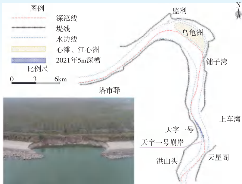
图 33 岳阳市华容县岳阳长江干堤桩号 27+680 ~ 27+790 段天字一号崩岸
