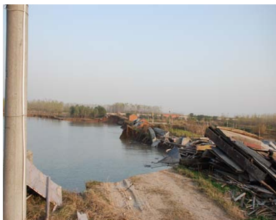
三江口崩塌现场之一
