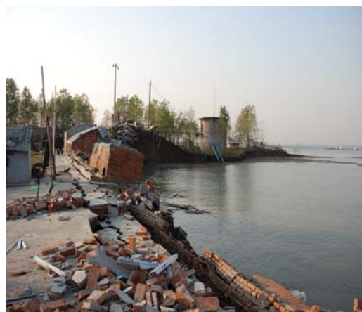
三江口崩塌现场之二
