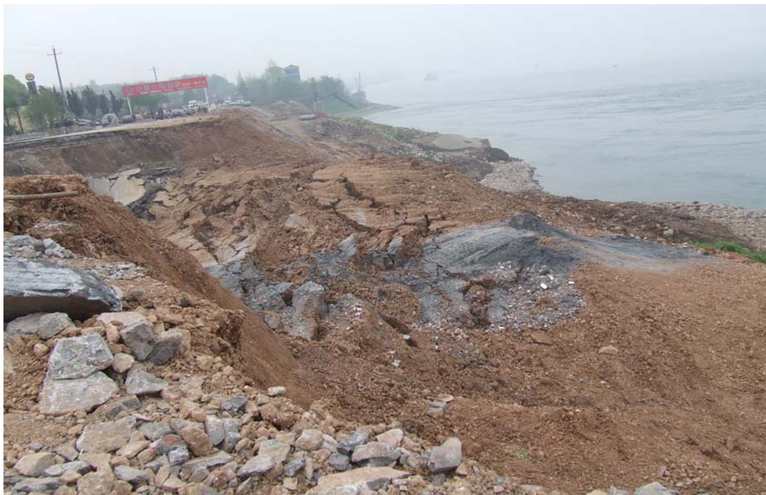
洋溪崩岸现场照片
