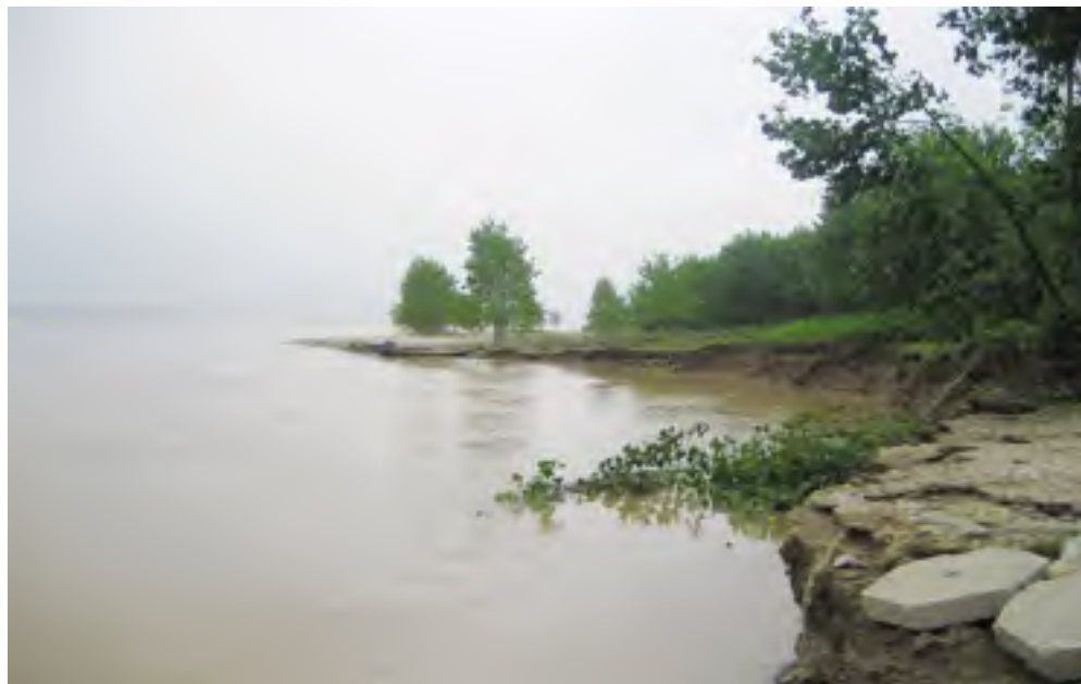
图 22 长江荆江门段桩号 4+160~4+380 崩岸
