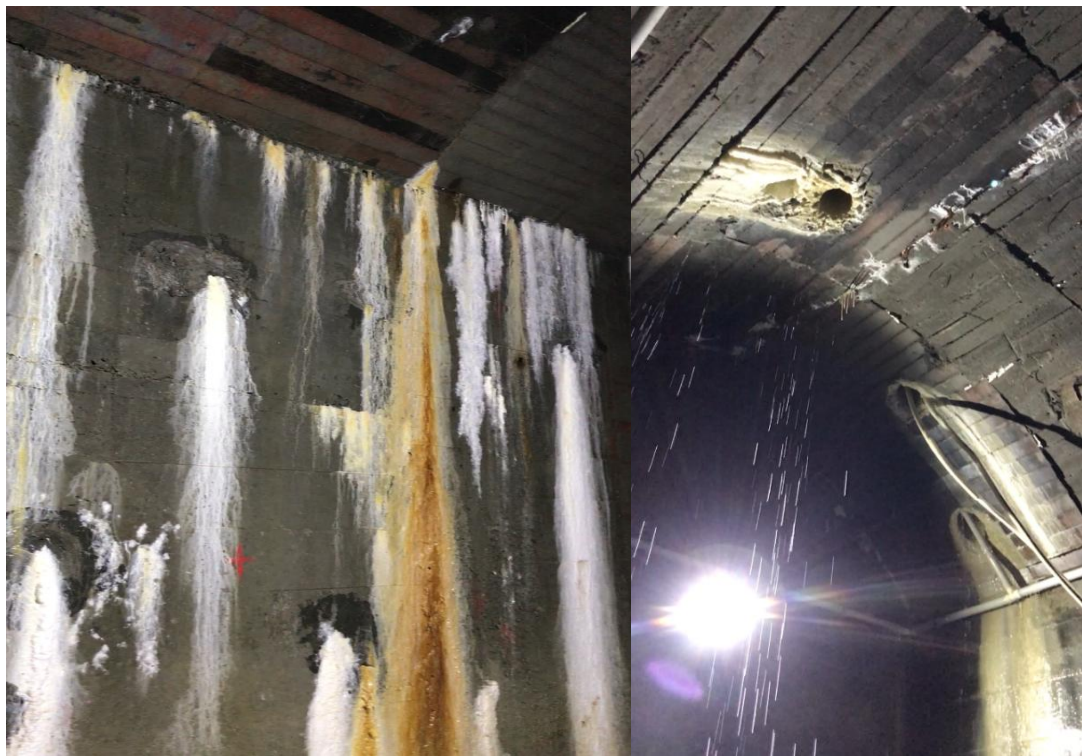
水利枢纽廊道渗漏
