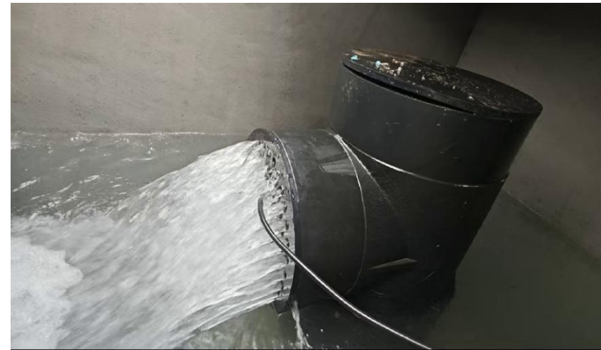
善卷垸减压井汛期出水 (2025.06常德)
